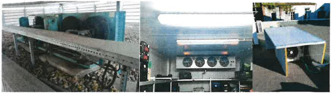
Figura 27 - Instalações de frio monitorizadas e acompanhadas pela S.ENERGIA
