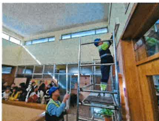
Figura 25 – Instalação de material do projeto EduLUX 2,3+ numa escola do Município de Loures
