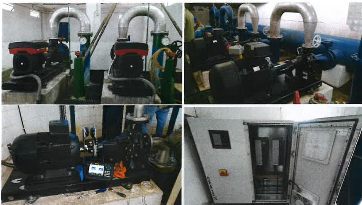
Figura 29 – Novos sistemas de bombagem instalados em 2024
