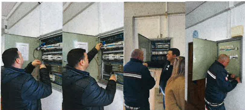
Figura 31 – Realização de medições de grandezas físicas no quadro elétrico de uma escola
